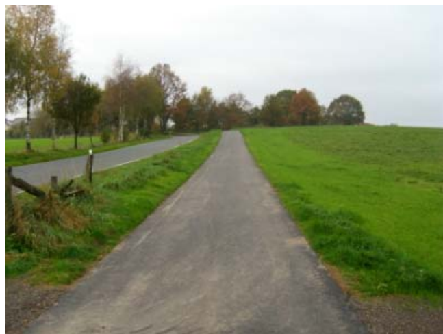
Bild oben: Der Fuß- und Radweg unmittelbar nach dessen Fertigstellung im Jahr 2005
